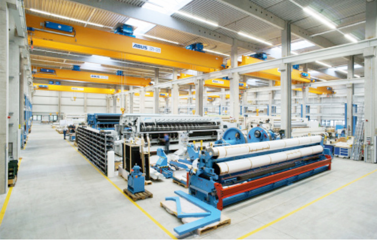
Gesteuert werden die Krane über eine Abus-Funkfernsteuerung. Sie ermöglicht dem Kranführer die Bedienung von einem sicheren Standort aus.
