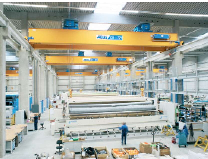
Alle Krananlagen sind mit je zwei Zweischienenlaufkatzen als Hebezeuge ausgerüstet, sodass sich auch große Maschinen mit weit auseinanderliegenden Lastanschlagpunkten sicher transportieren lassen. (Bilder: Abus)
